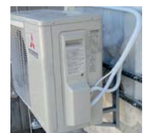
Подогрев дренажа кондиционеров
